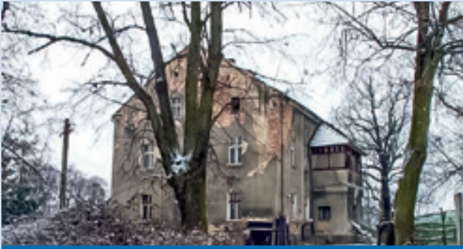
Dwór w Łukowie Śląskim po II wojny światowej - stan przed remontem ( www.palaceslaska.pl )
